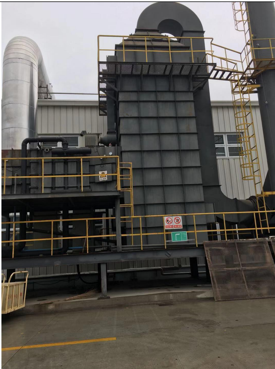
静电除尘设备，主要用于定型机废气处理，降低废气中 VOC 等含量，落实国家环保要求
