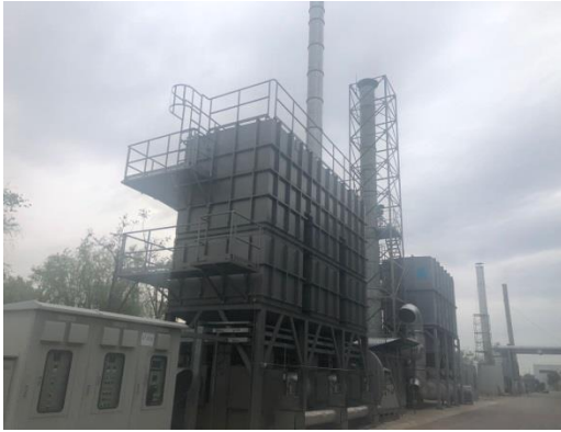
废气处理装置
