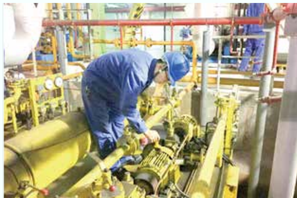
技术人员对机组进行巡检
