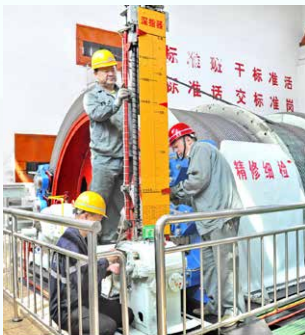
员工对设备进行班中巡检
