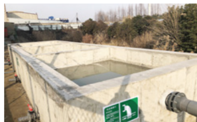
升级改造后的污水排口隔断系统。
