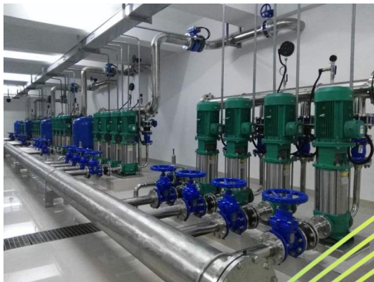
◎ 二次供水泵房
