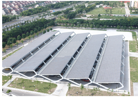
上海闵行航天城电站
