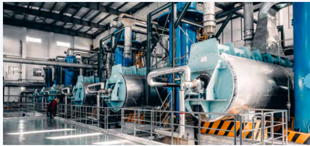
珞璜电厂污泥发电项目
