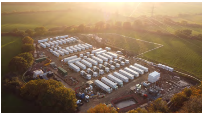
英国门迪 100MW 储能项目
