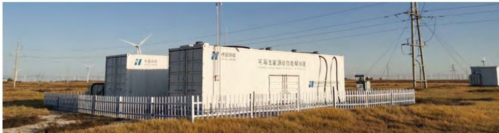
风电动态电解制氢示范工程
