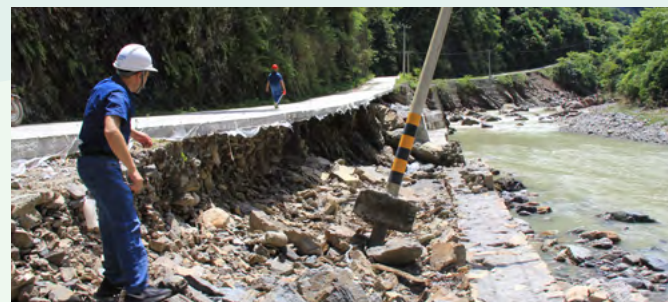
青龙水电站进坝公路冲毁
