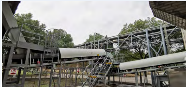
苏州热电污泥发电项目
