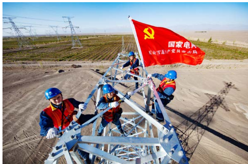
国网天山雪莲共产党员突击队 对 220 千伏哈岭线进行竣工验收
