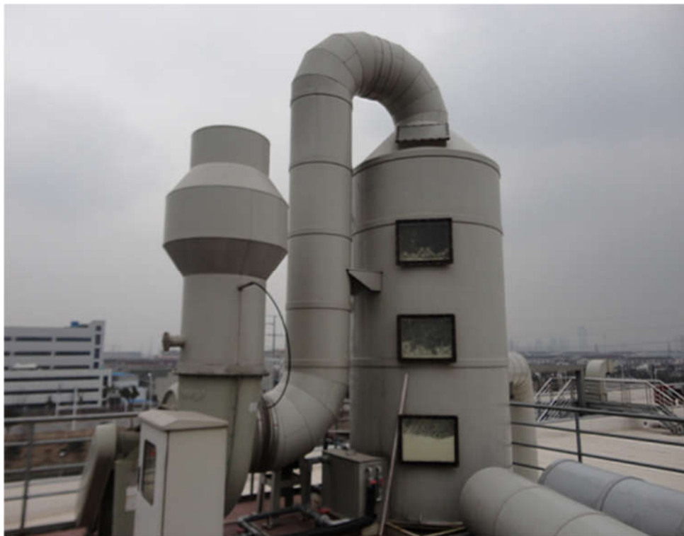
图 32：厂区废气处理塔
