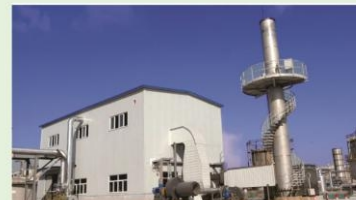
沼气回收利用装置
