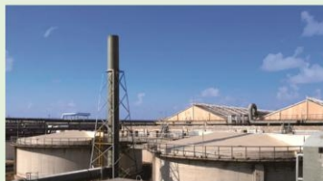
污水预处理废气收集处理系统
