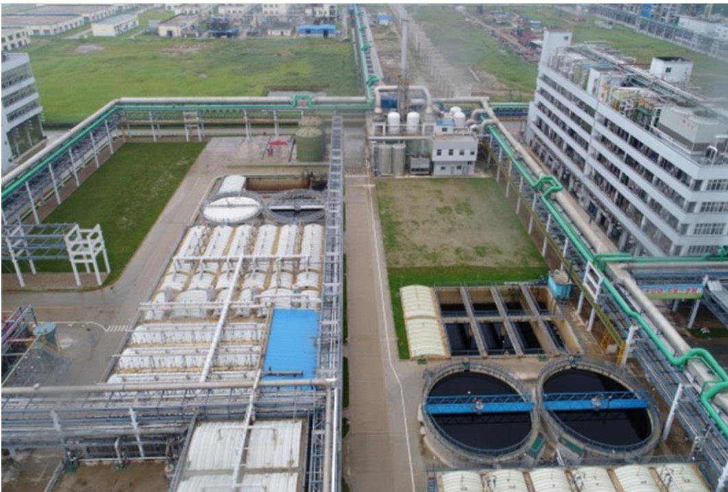
全封闭式废水处理装置
