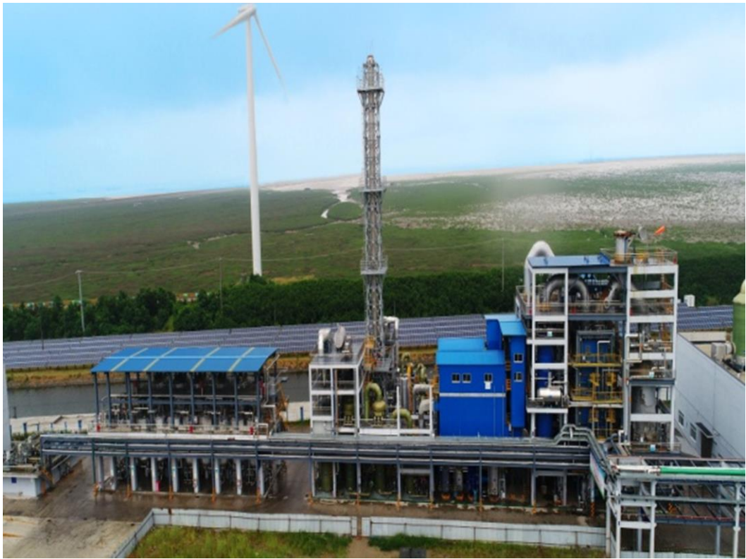
先进的固废焚烧装置
