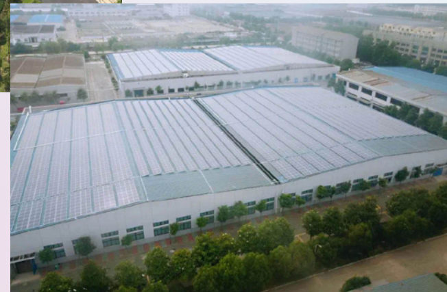
洪泽县宏港毛纺有限公司光伏项目
