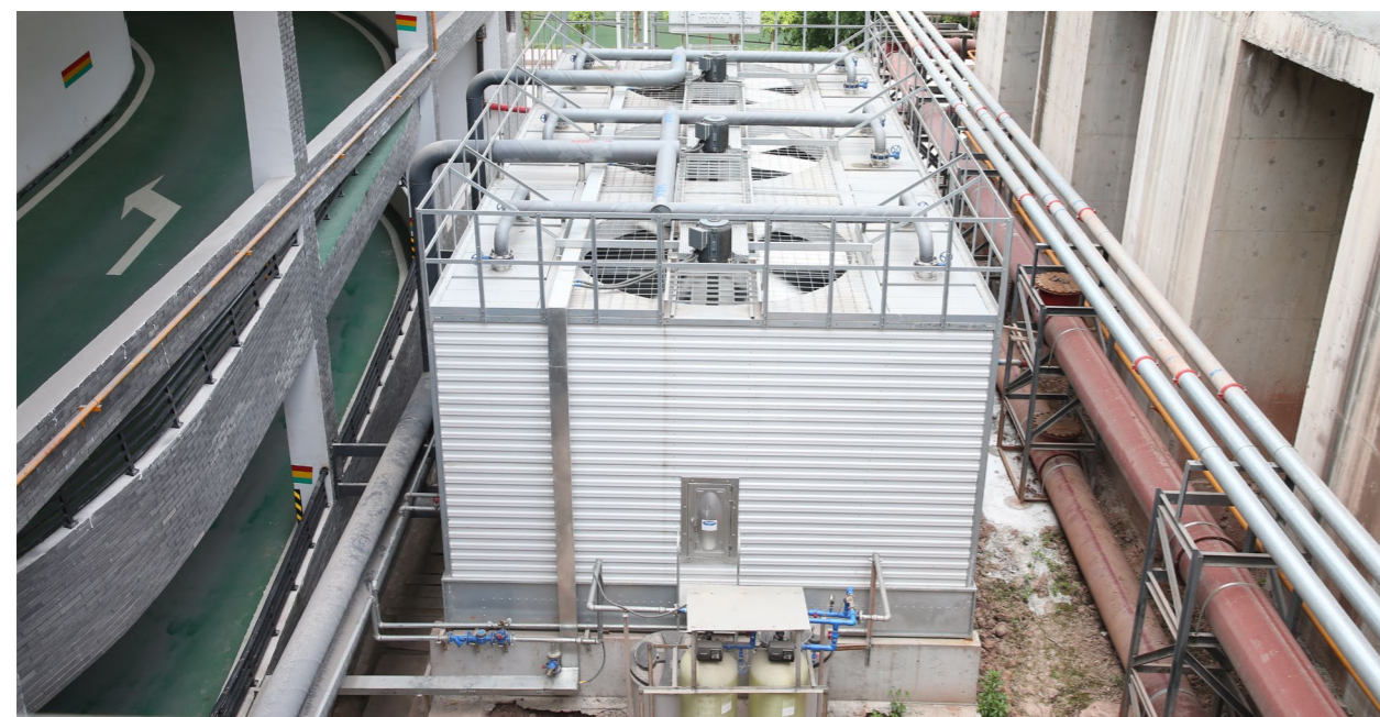
茅台集团总投资4.3亿元，在全厂建设并投用23套冷却水循环利用系统，有效提升水资源利用率
