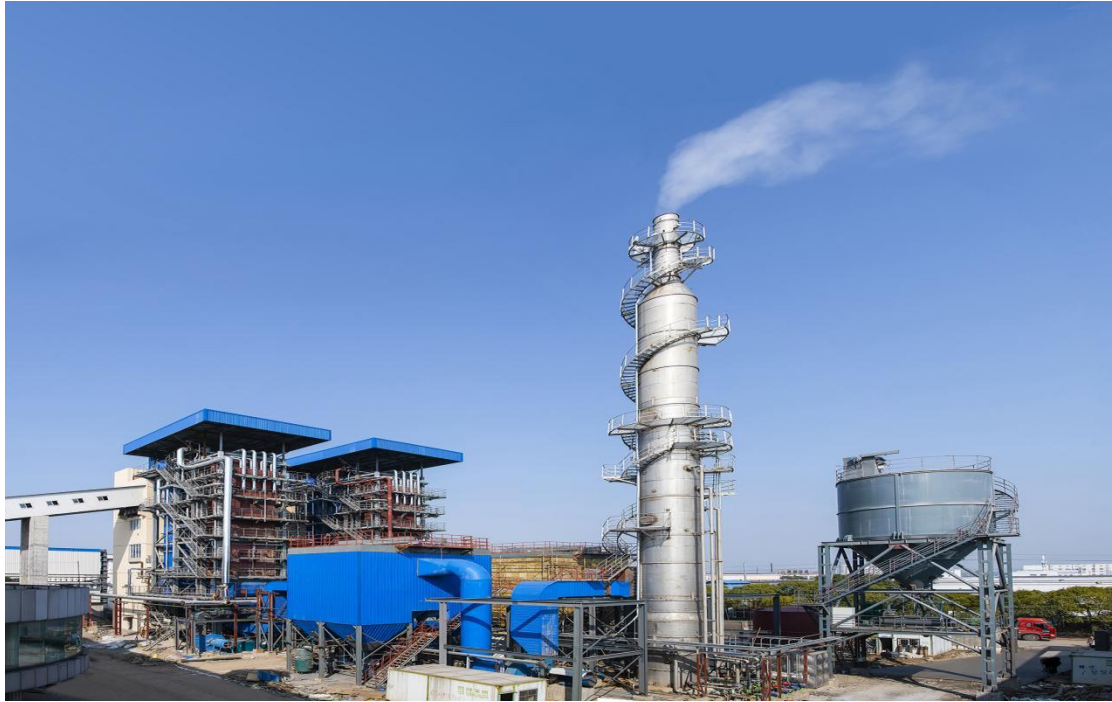
公司燃煤锅炉
