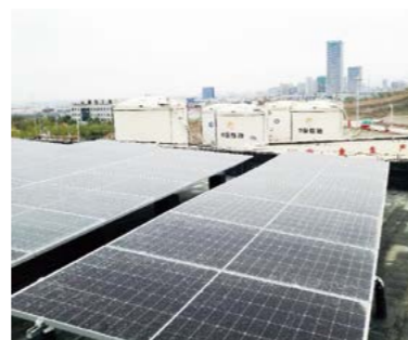
西山油库办公楼屋顶光伏板
