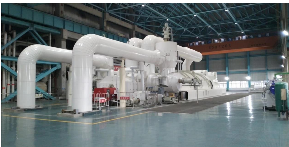
大唐安徽淮南洛河5号机组升级改造项目汽轮机组
