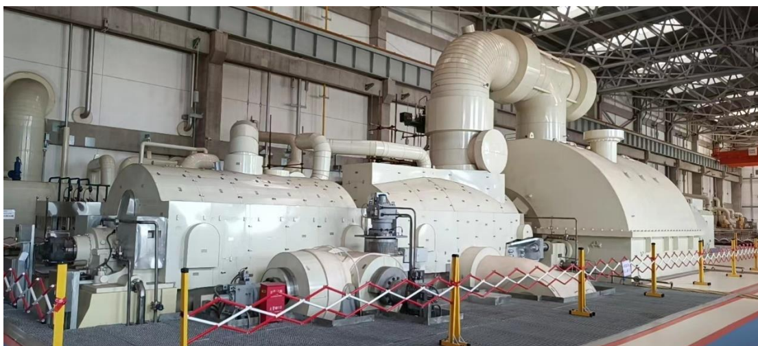
华能青岛（董家口港）350MW 三缸两排汽双抽凝汽式汽轮机
