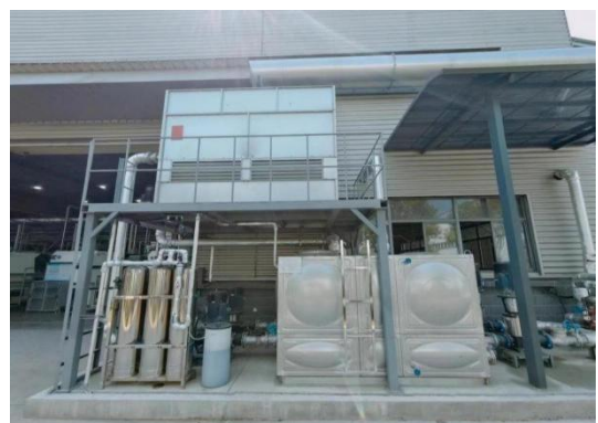
废气处理设备
