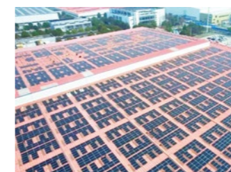
江汽屋顶光伏项目
