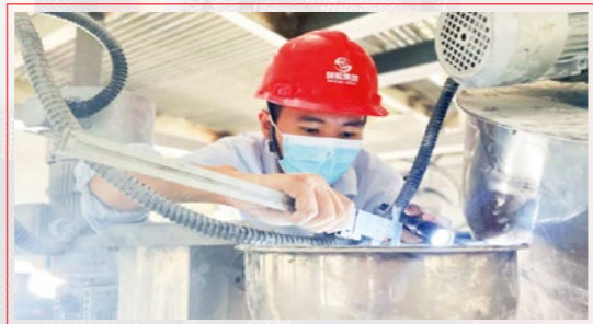
长丰皖能环保公司生产部门人员坚守岗位，为机组安全稳定保驾护航
