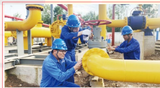
省天然气公司怀远输气站站场员工开展工艺设备检查维护工作
